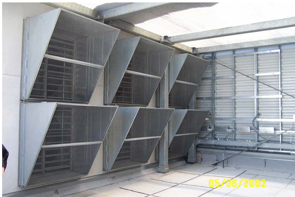
Figure 105. Relief Fan Discharge
