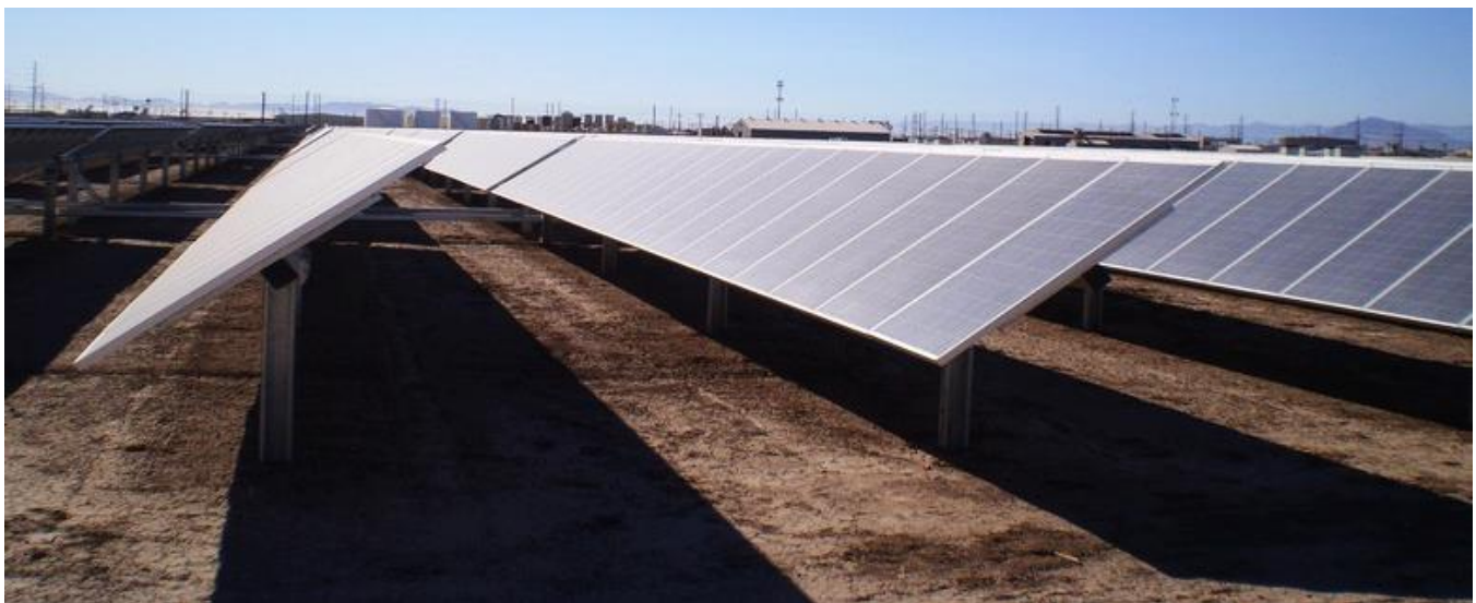
El Centro Solar Park
