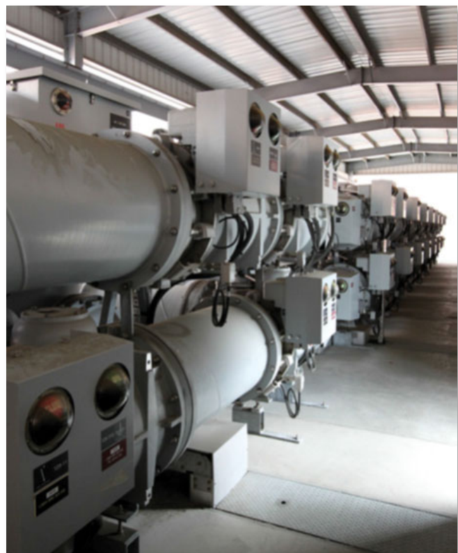
Photo 2: Vermont 220kV GIS Switchgear
