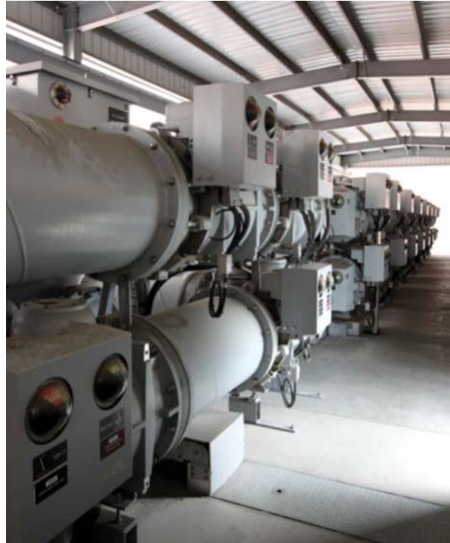
Photo 1: Vermont 220kV GIS Switchgear
