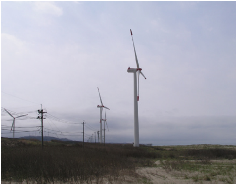
【図6】 風車の周辺に高さ1mほどの低木林が存在している。写真は葉が落ちている時期であり、葉の茂る時期よりは調査しやすいと思われる。(秋田新屋ウインドファーム／秋田県)
