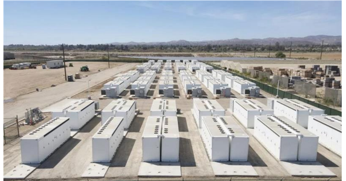
Fuente: Arevon Asset Management
